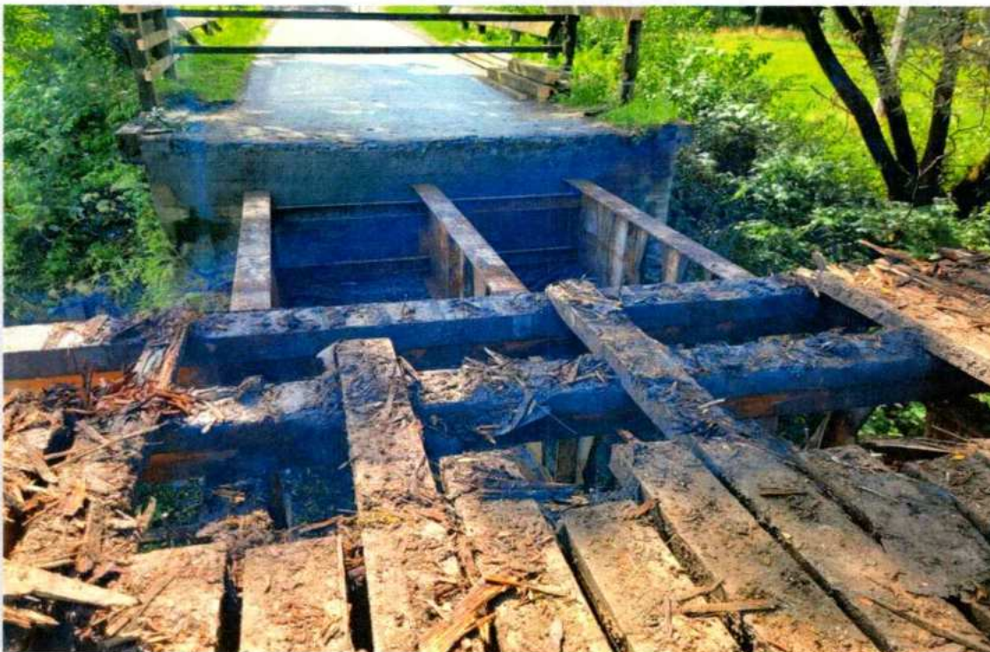
Remont mostu drewnianego w m. Kwiatów w ciągu drogi 1497K Kwiatów-Regietów – Smerekowiec w km 0+098.
