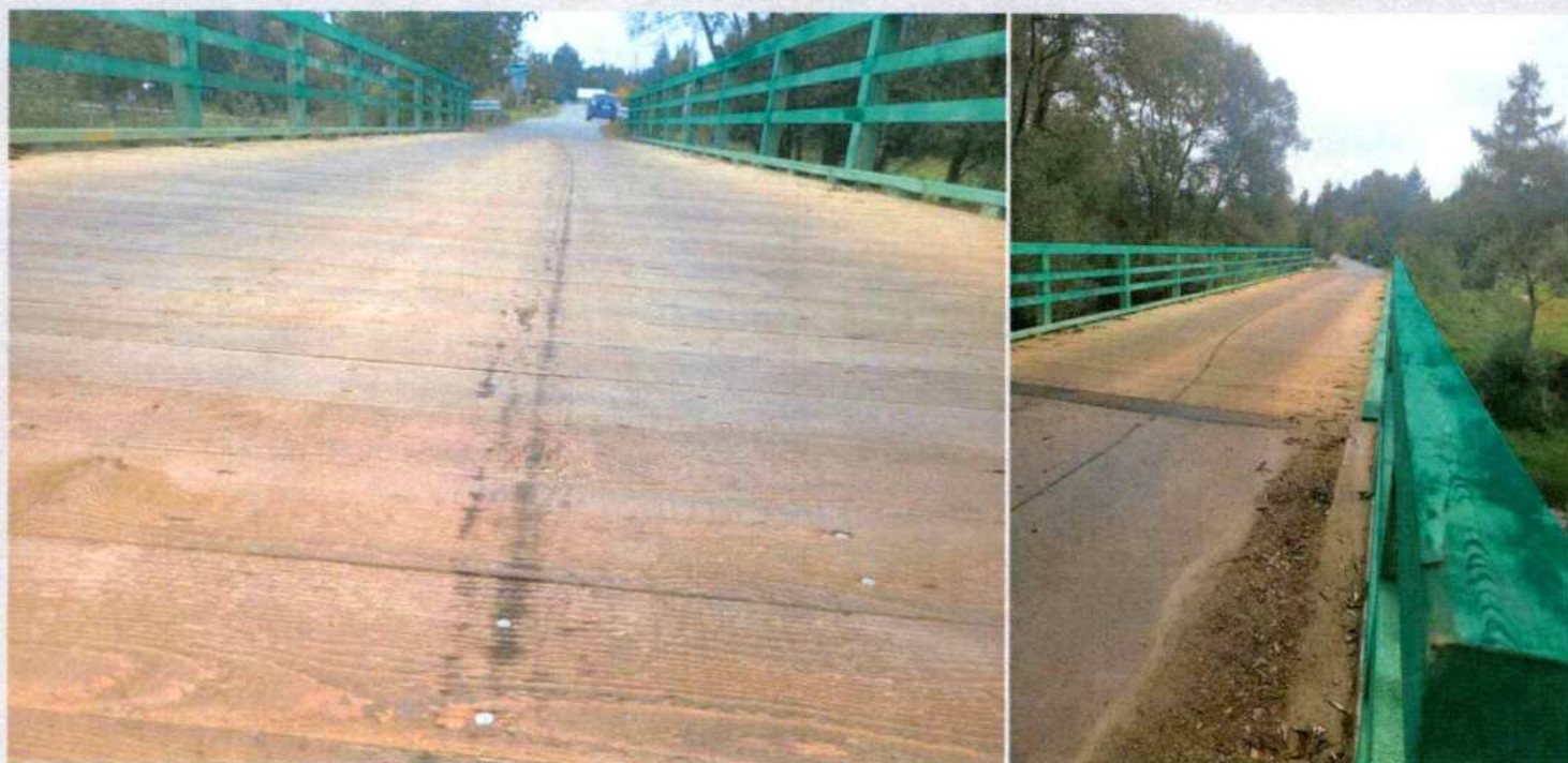
Remont mostu drewnianego w m. Kwiatów w ciągu drogi 1497K Kwiatów-Regietów – Smerekowiec w km 0+098.
