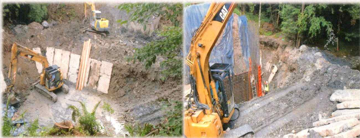
Rozbudowa drogi powiatowej 1507K Szymbark - Bystra - Szalowa wraz z rozbiórką istniejącego mostu i budową nowego mostu w km 2+135,83
