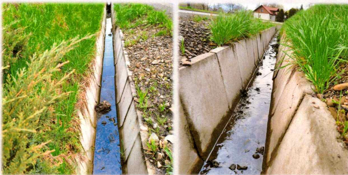
Wykonanie umocnienia rowu elementami betonowymi w ciągu drogi powiatowej 1498 K Ropa - Wysowa Zdrój - Blechnarka - Granica Państwa w km 1+820-1+955 w miejscowości Ropa
