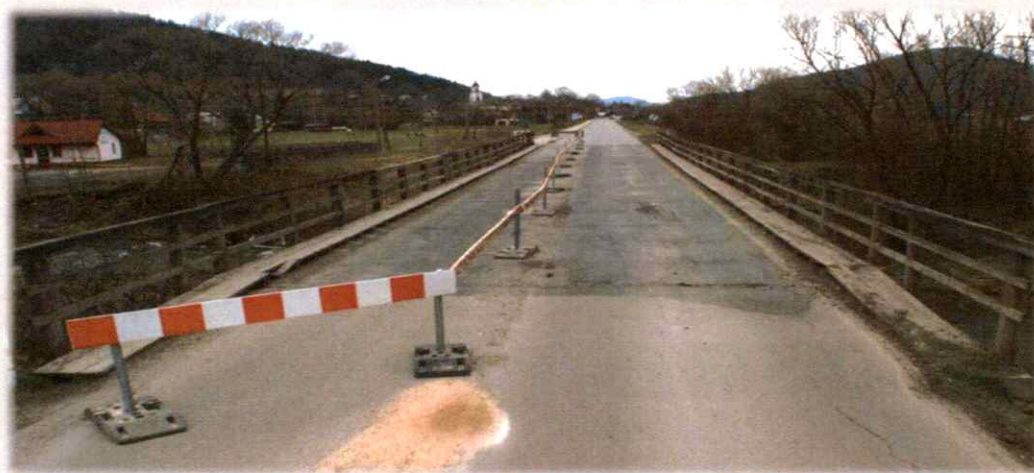
Wykonanie doraźnego zabezpieczenia mostu znajdującego się w ciągu drogi powiatowej 1496K Gładyszów – Uście Gorlickie w km 9+931
