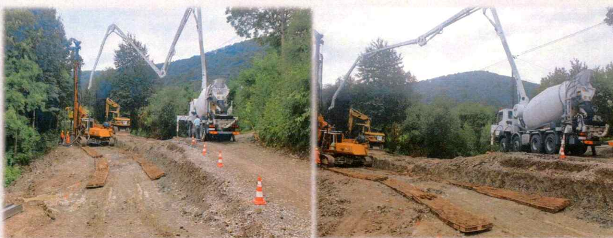
Stabilizacja osuwiska w miejscowości Ropa w ciągu drogi powiatowej 1504K Ropa- Wawrzka -Florynka wraz z odbudową drogi w km 2+112 - 2+149 i przepustu w km 2+135.
