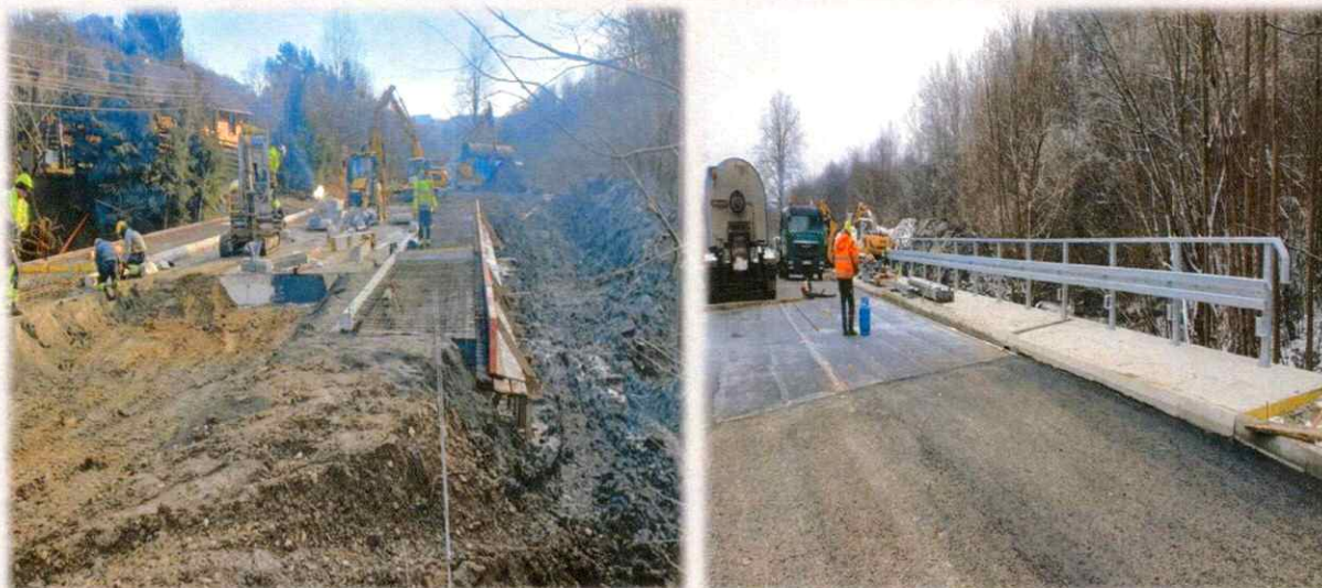
Rozbudowa drogi powiatowej 1507K Szymbark - Bystra - Szalowa wraz z rozbiórką istniejącego mostu i budową nowego mostu w km 2+135,83
